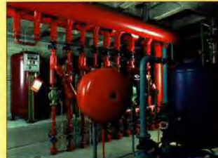
Installation de chauffage: vase d'expansion.
