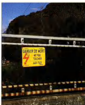
Ne pas s'approcher des lignes électriques, danger de mort!
