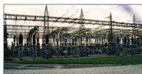
Poste de transformation du réseau international.
