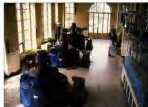
Alternateur de centrale électrique.
