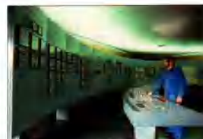
Salle de contrôle.
